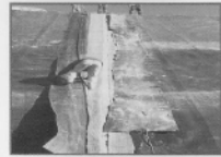
Brak uszczelnienia z powodu skurczenia się mat wykonanych bez domieszki haloizytu
